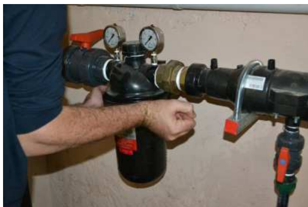
Fotografia 1. Neteja manual d'un filtre d'anelles amb aigua a pressió.
